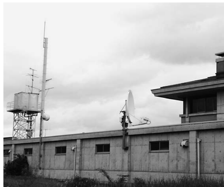
役場庁舎に設置されているJアラート（全国瞬時警報システム）
